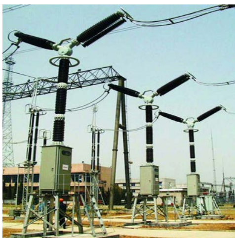
Εικόνα 10 Συστοιχία Διακοπών Υψηλής Τάσης
